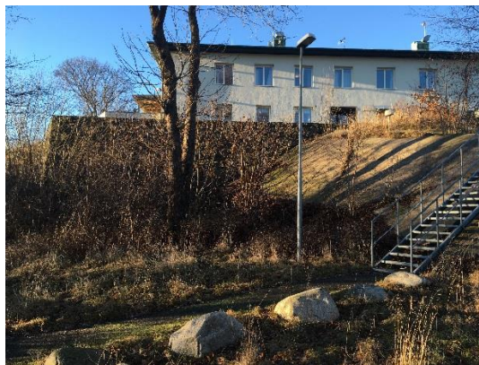
Foto 2. Berg i dagen samt stenmuren i gott skick
